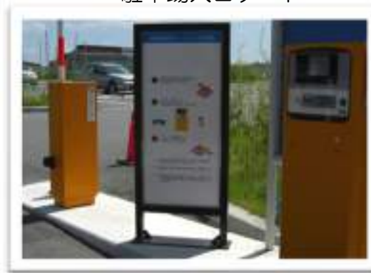
駐車場入口ゲート
